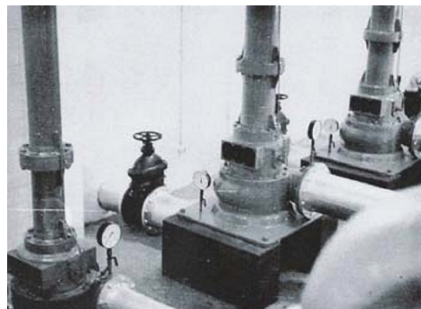
Estação Elevatória nº2: vista interior do 1º Piso com as bombas maiores e uma das menores
