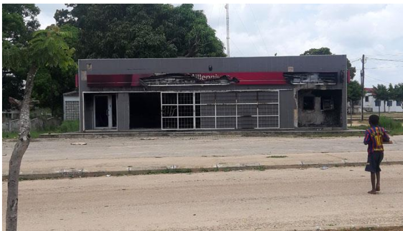
Foto 6: Aspecto da destruição de estabelecimento bancário em Mocímboa da Praia
