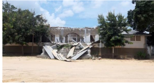
Foto 4: Destruição do Hospital Rural de Mocímboa da Praia
