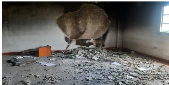
Foto 1: Vandalização das instalações da Procuradoria Distrital de Mocímboa da Praia
