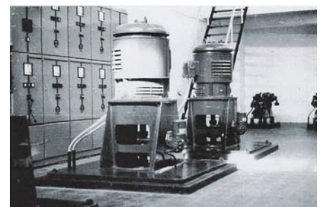
Estação Elevatória nº4: vista interior do 3º Piso com o quadro eléctrico e os motores de 52 cavalos e os compressores. (Fase posterior avançada)
